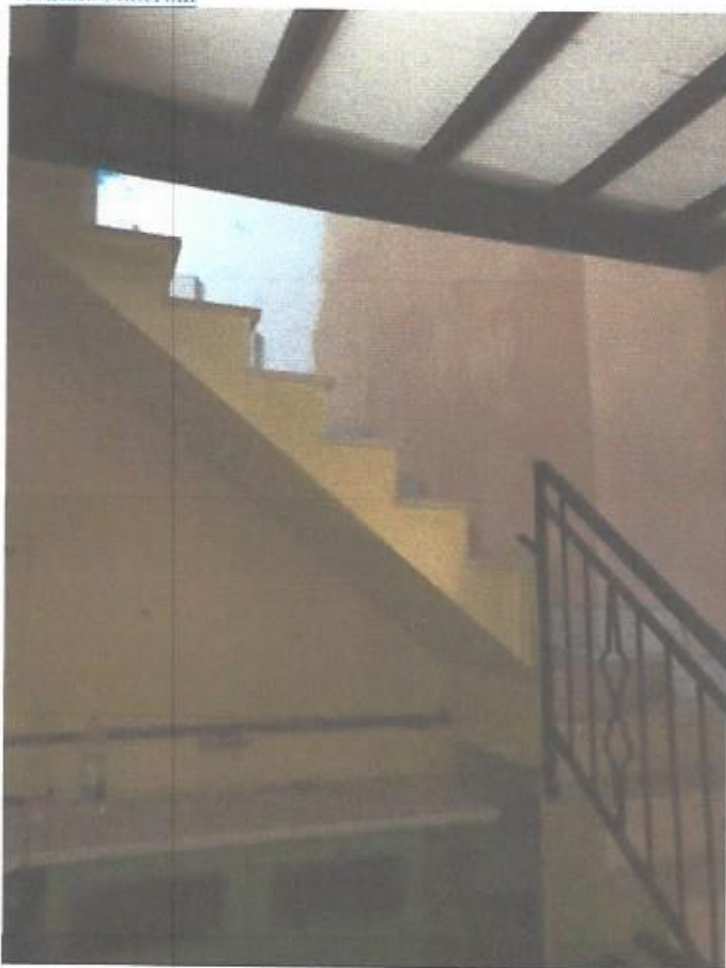
Vano cucina p.lla 466 con scala di accesso al piano primo con vista solaio interpiano
