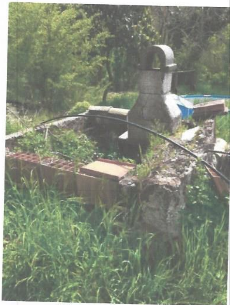
resti del manufatto presente sulla p.lla 1676
